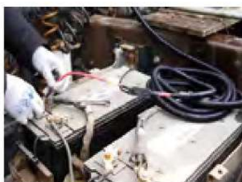
5. Подключить провода электропитания к АКБ
